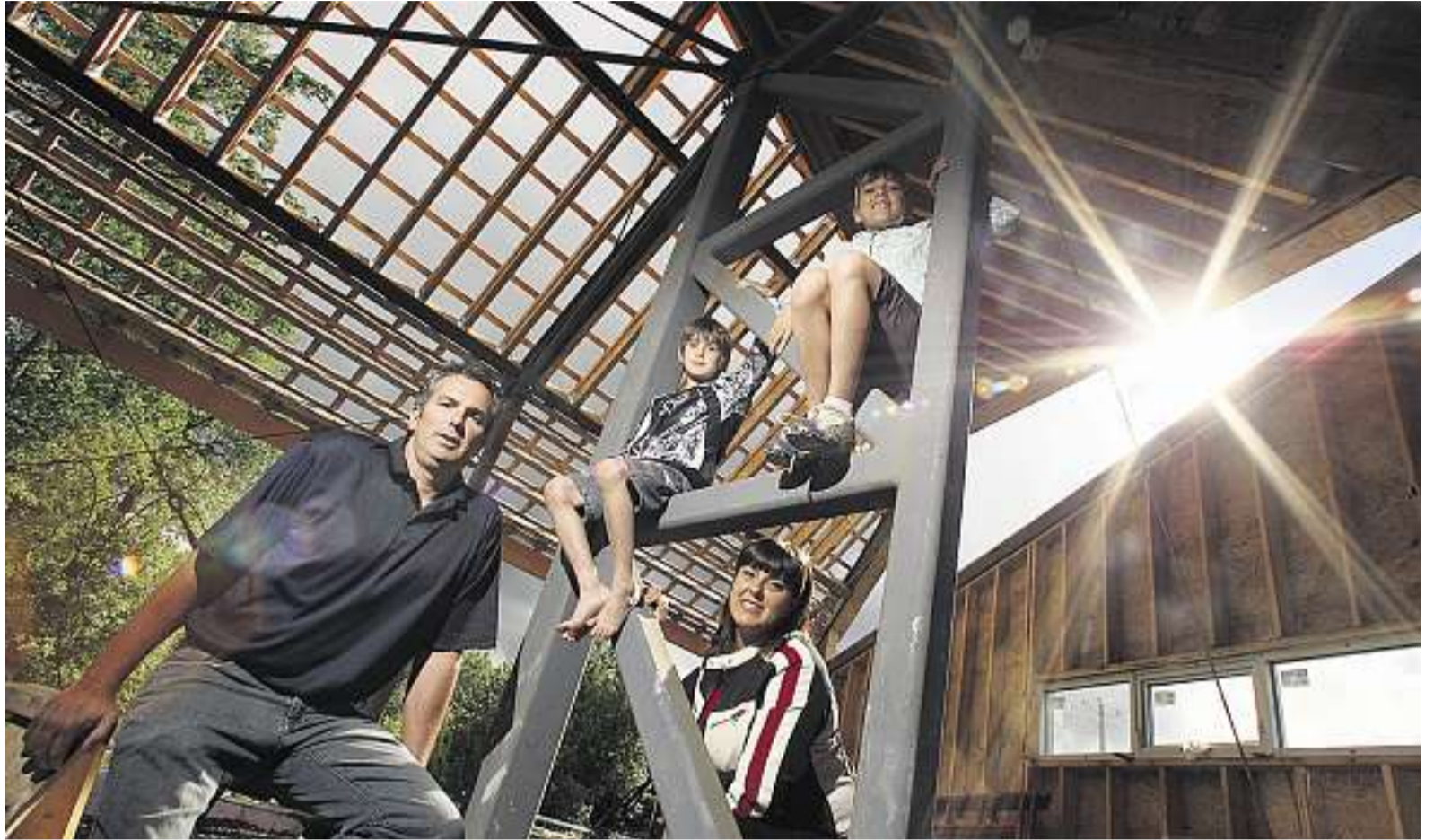
La maison Pure Énergie, à Saint-Basile-le-Grand, prend forme. Habitant à côté avec leurs deux enfants, Chloé et Philippe, Danielle Chevalier et Denis Brault suivent de près la progression du chantier. Ce qui les enchante? Les immenses fenêtres qui borderont le salon et la salle à manger.
